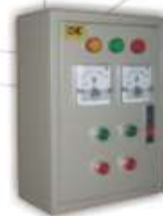
TỦ ĐIỀU KHIỂN CONTROL PANEL
